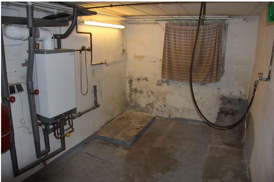
Technik im Keller
