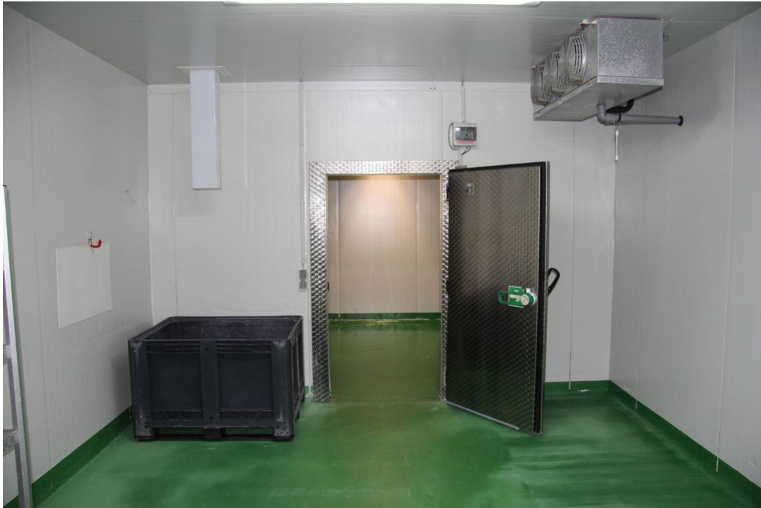
Kühlraum und anschließender Gefrierraum
